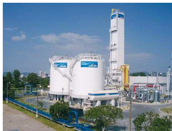
Zásobníky kapalného kyslíku a Lindeho kolona
