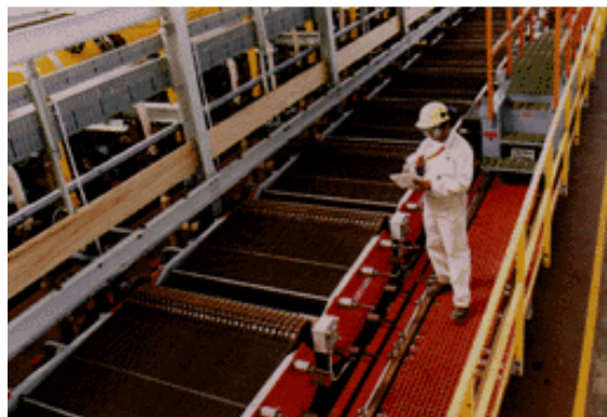
Baterie membránových elektrolyzáru. Každý blok obsahuje asi 20 svislých membrán o ploše asi 1×1 m
