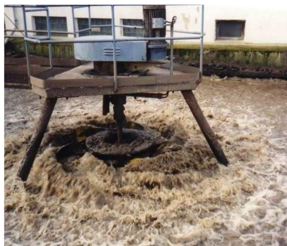
Aktivační nádrž provzdušňovaná povrchovým míchadlem
