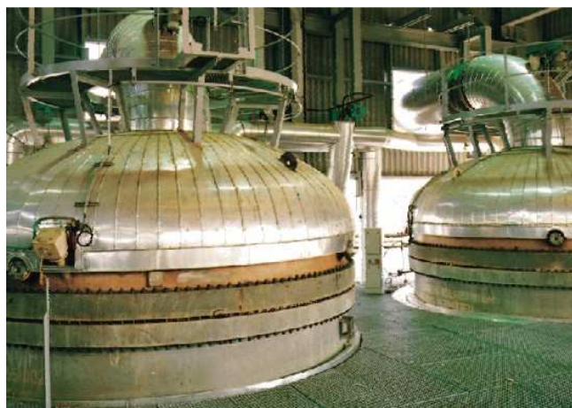
Reaktory pro oxidaci 260 t amoniaku za den . Průměr 5 m.
