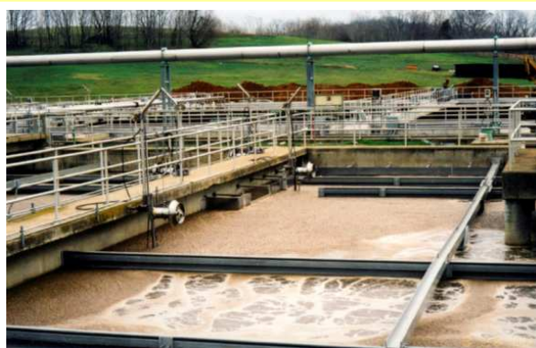
Aktivační nádrže provzdušňované tlakovým vzduchem
